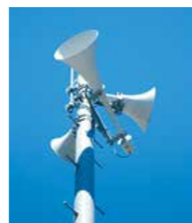
防災無線 屋外スピーカー
