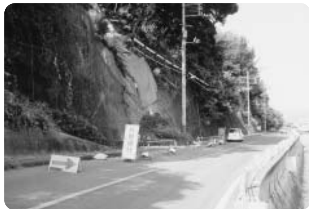
▲ 梅雨災害による土砂崩落状況（沖美町三吉）
