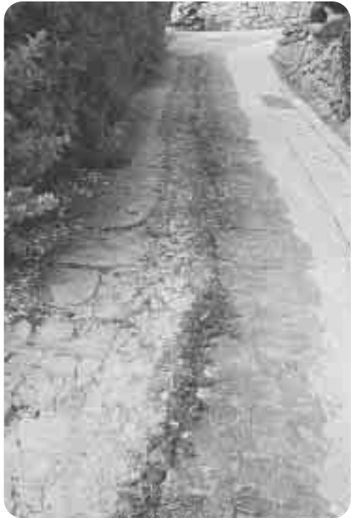
▲傷んだ生活道路
