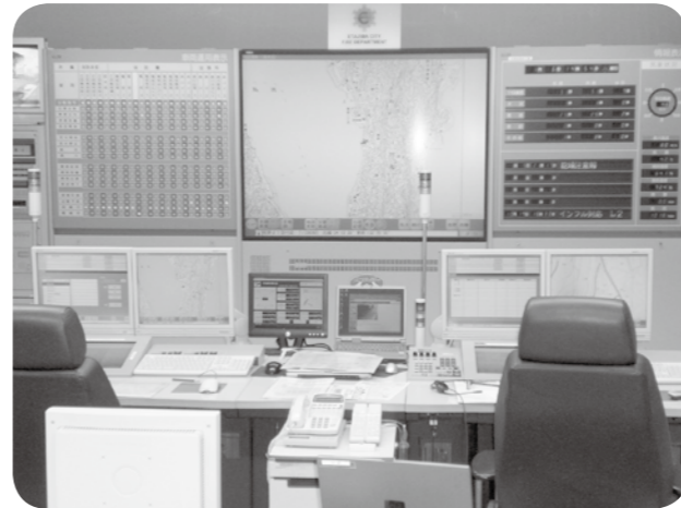
▲ 高機能指令システム (消防本部)
