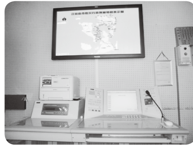
▲ 防災行政無線 (平成22年度整備)
