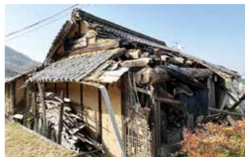
倒壊しそうな空き家
