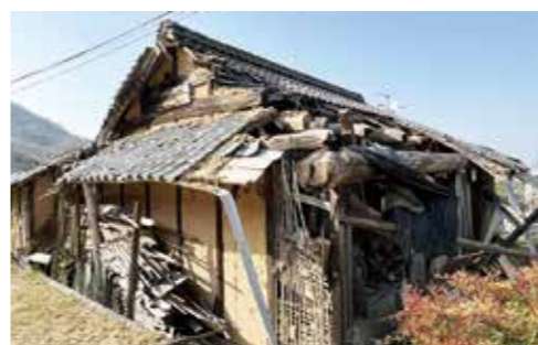
倒壊しそうな空き家
