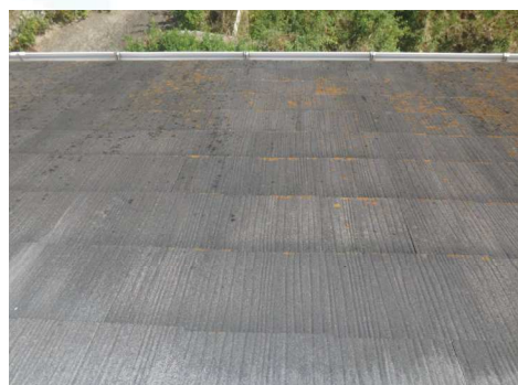
屋根外壁が劣化、洗浄塗装が必要
