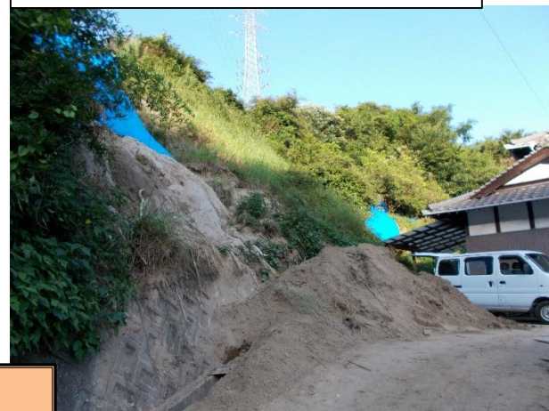
斜面崩壊・被災状況（H30年7月）
