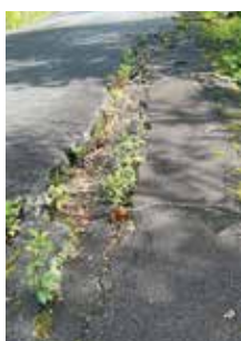
ひび割れたアスファルト道路
