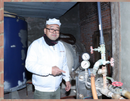
▲生揚醤油の火入れで使用使用するプレートヒーター。風味の要となります
