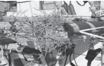
（写真左）電柱に作られたカラスの巣
