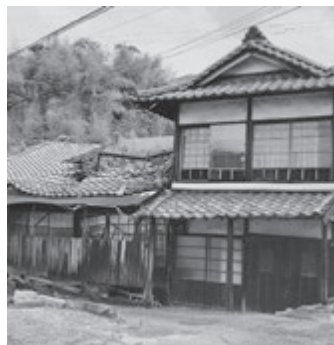
↑江田島市内にある危険な空き家
