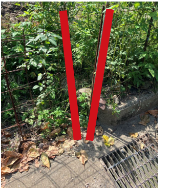
▲ワイヤーメッシュの接続部分が壊されている
